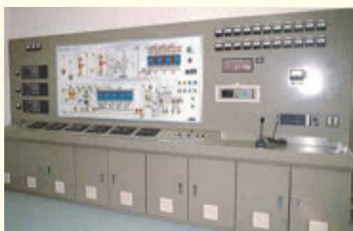
荷受、乾燥、出荷等の工程を集中管理
