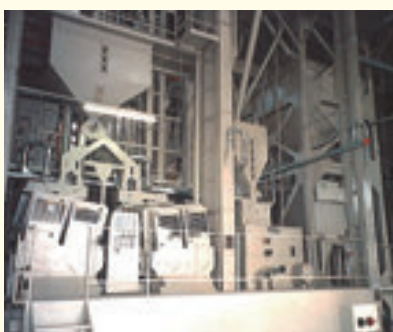
荷受・精選・籾摺ユニット
